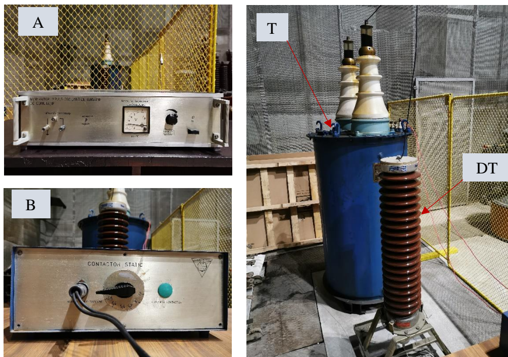
Fig. 5 – Detalii grafice asupra elementelor ce alcătuiesc instalația de producere a impulsului de tensiune de comutație, oscilant amortizat
